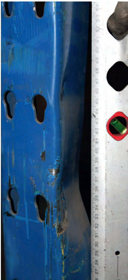
Beschädigte Stütze. (Bilder: R.O.S.)
